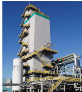
図 1-3-5 深冷空気分離装置の外観、出典：太陽日酸 WEB サイト
