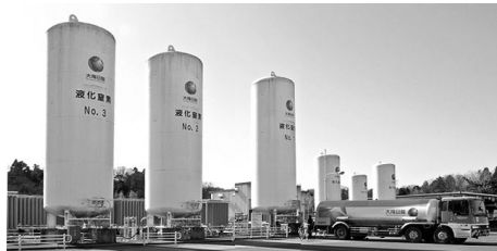
図 4-6-2-CE（コールドエバポレーター、低温液化ガス貯槽）とタンクローリー
