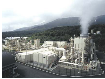
図 6-7-6-4 東京電力八丈島発電所
